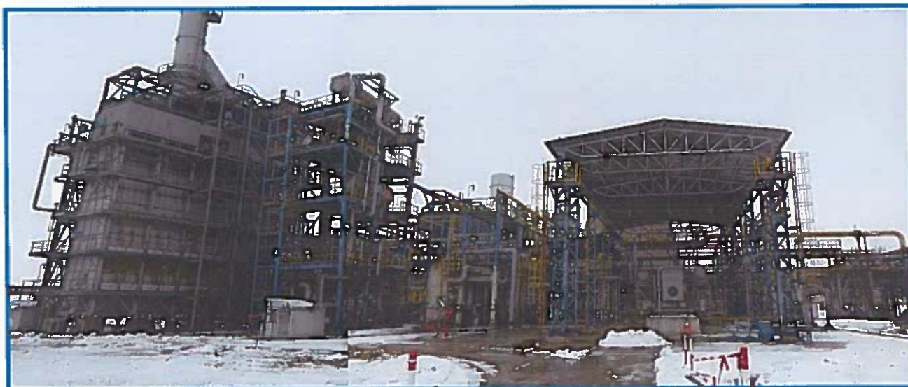
Figura 4. Vedere generala Fabrica de Hidrogen 23.01.2019
