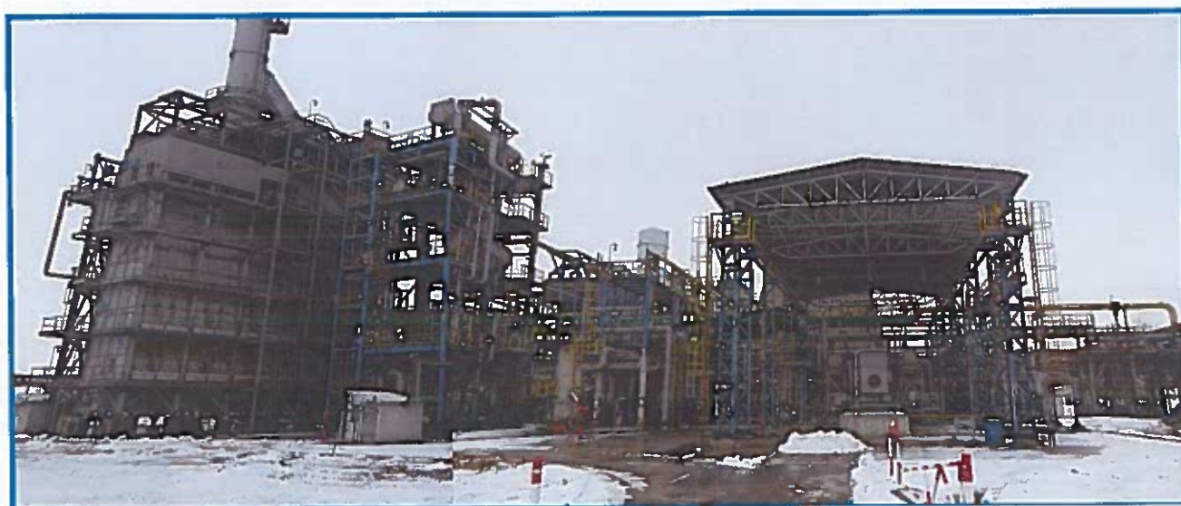
Figura 4. Vedere generala Fabrica de Hidrogen 23.01.2019
