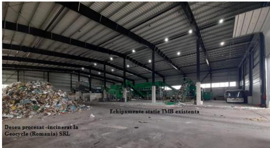
Foto 1: Instalatia de tratare mecanica – vedere interioara
