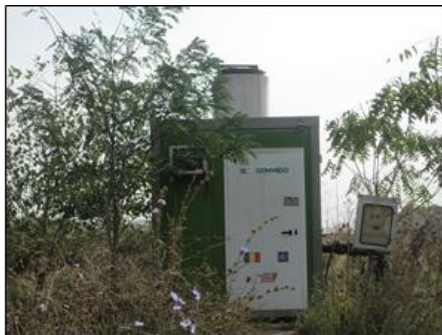
Foto 1 Stație de captare și ardere bioga
