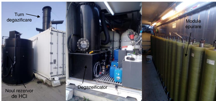
Foto 11 Stația de epurare cu osmoza inversa
