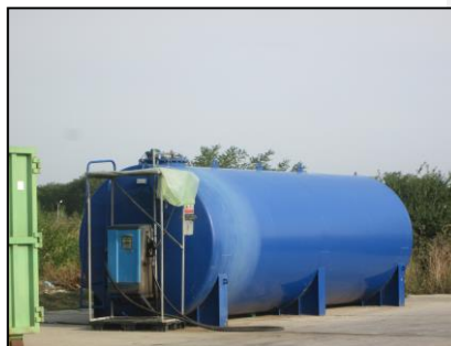
Foto 15 Stație mobilă combustibil
